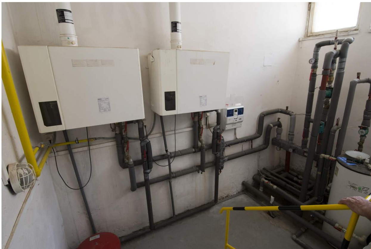
Kotelna s dvomi plynovými kotlami
